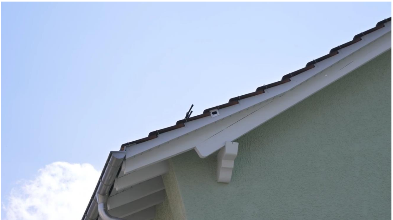
Abbildung 35: In die Dachtraufe integrierte Nisthilfe für Mauersegler © Einwohnergemeinde Cham
