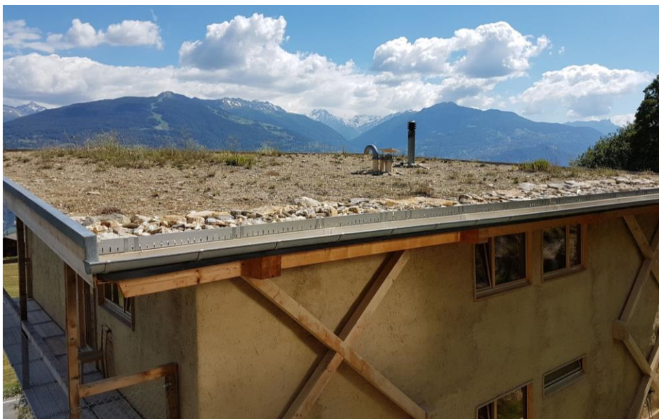
Abbildung 30: Dachbegrünung unter extremen klimatischen Bedingungen © Nathalie Baumann
